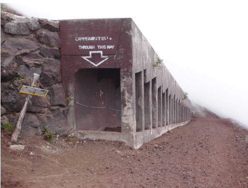
途中で落石よけのシェルターもある (中の階段の段差がひどい)
